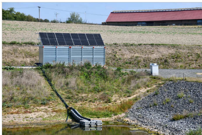
Obrázek 2.4: Jímací zařízení stabilního solárního přečerpávání.
